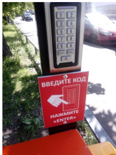
Внешний вид установленной кодонаборной панели. Перечень событий по проезду через систему заявок
